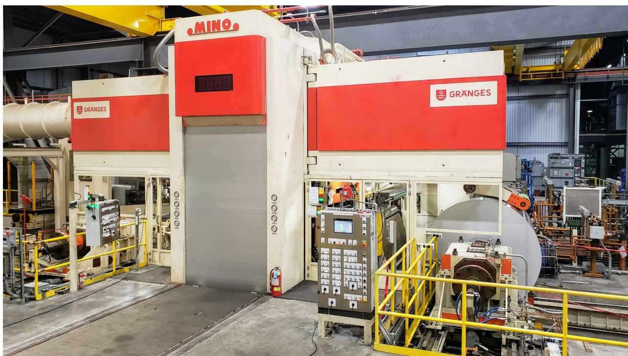
Nytt kallvalsverk vid Gränges fabrik i Huntingdon, Tennessee.
